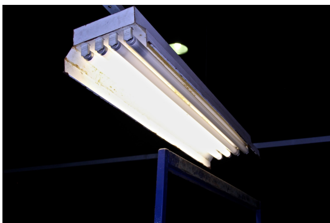
Figura 33 – Luminária com lâmpadas queimadas Fonte: Arquivo Pessoal (2012)
