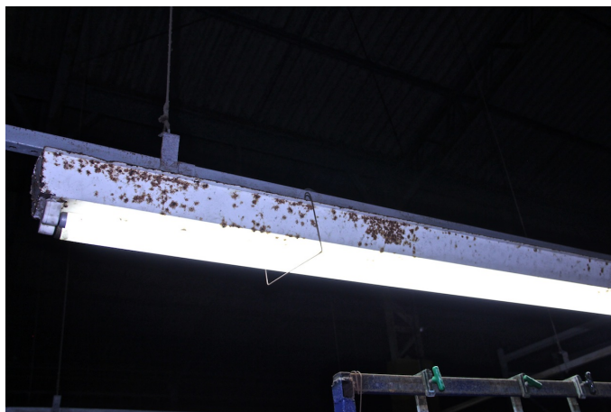
Figura 36 – Luminária com corrosão Fonte: Arquivo Pessoal (2012)
